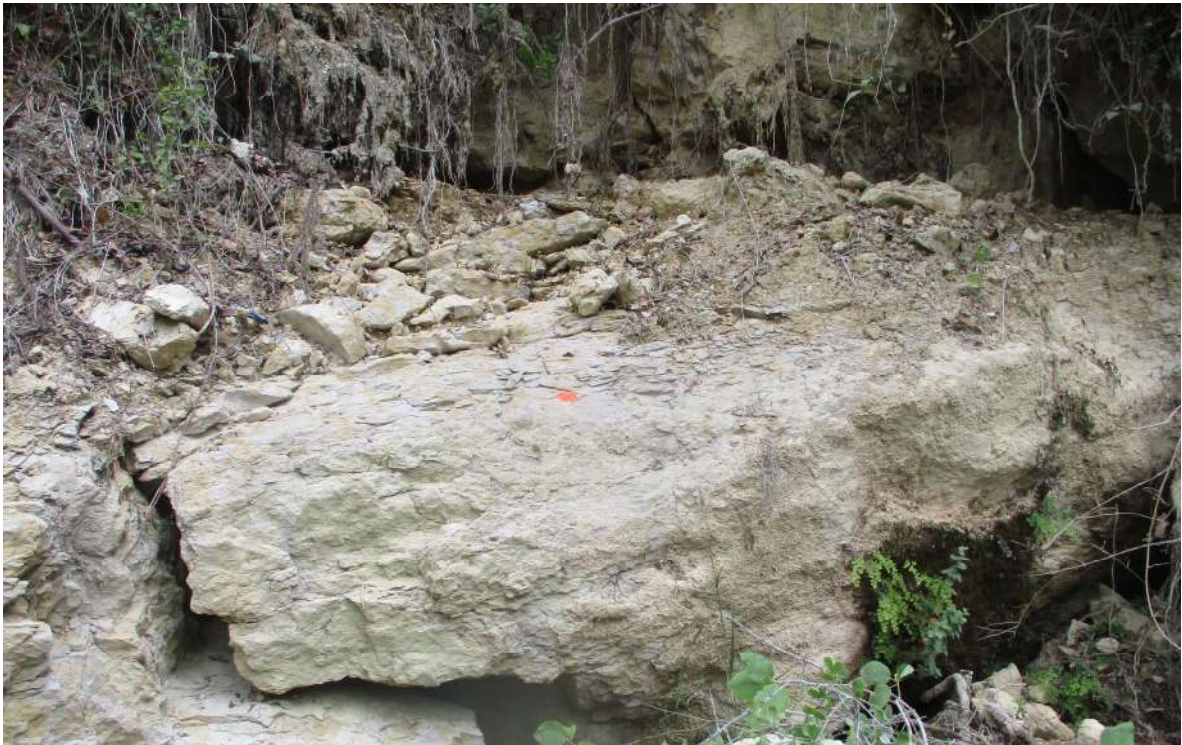
DETALLE ROCA DESPRENDIDA
