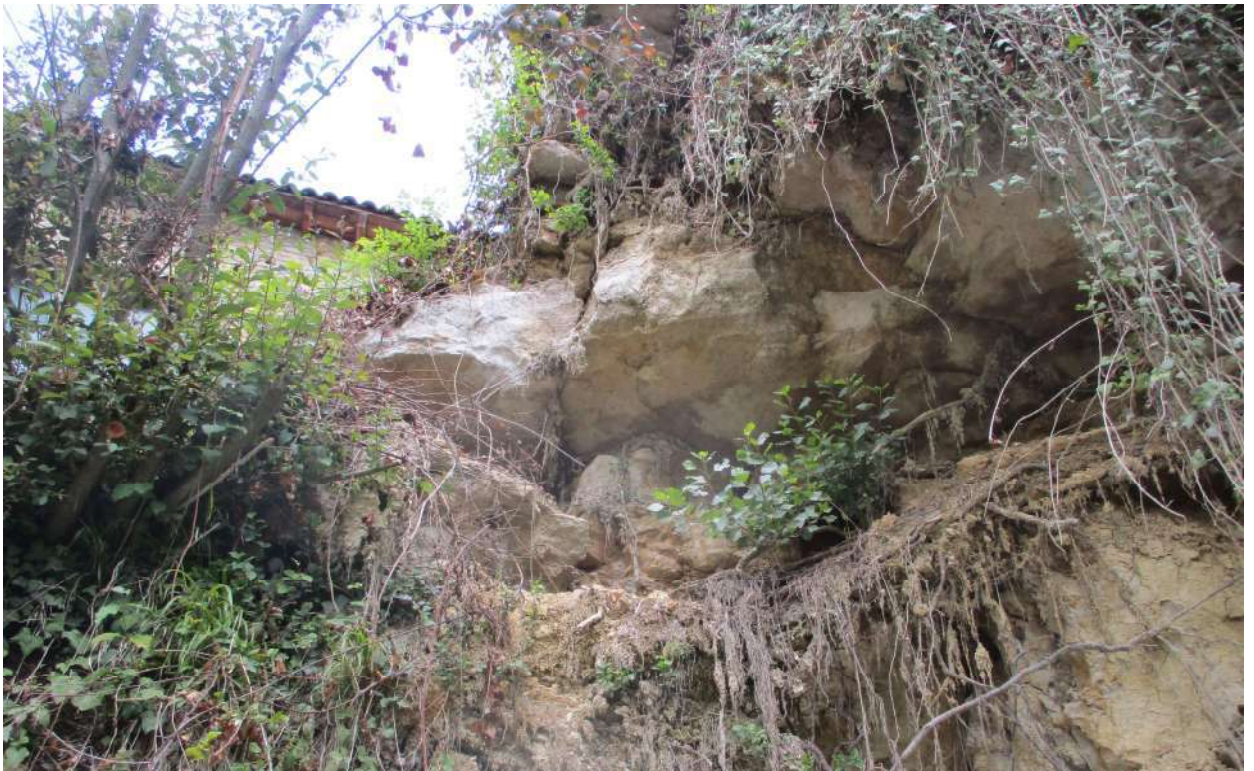
DETALLE TALUD DE ROCA (MUY EROSIONADO)
