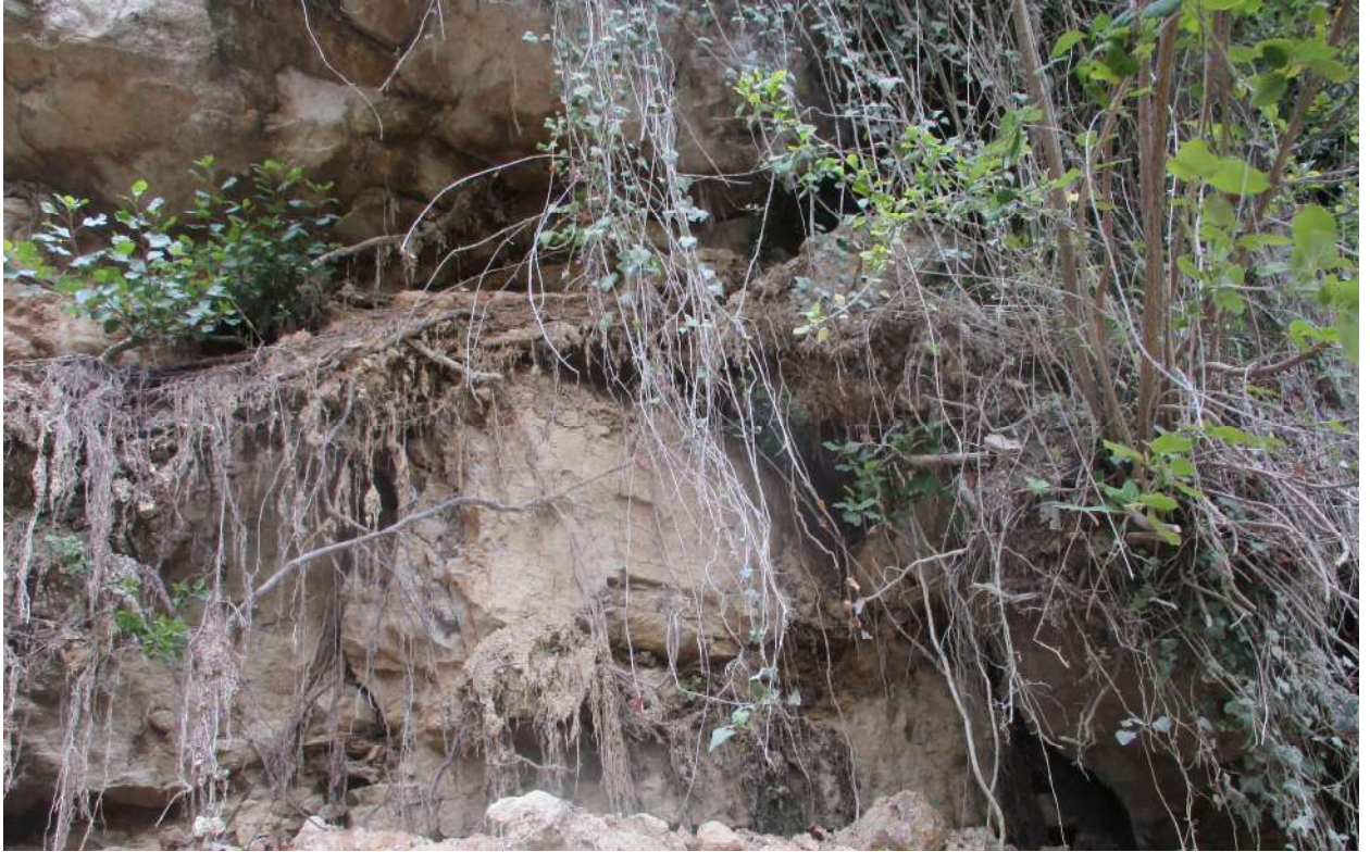
TALUD DE ROCA (MUY EROSIONADO)
