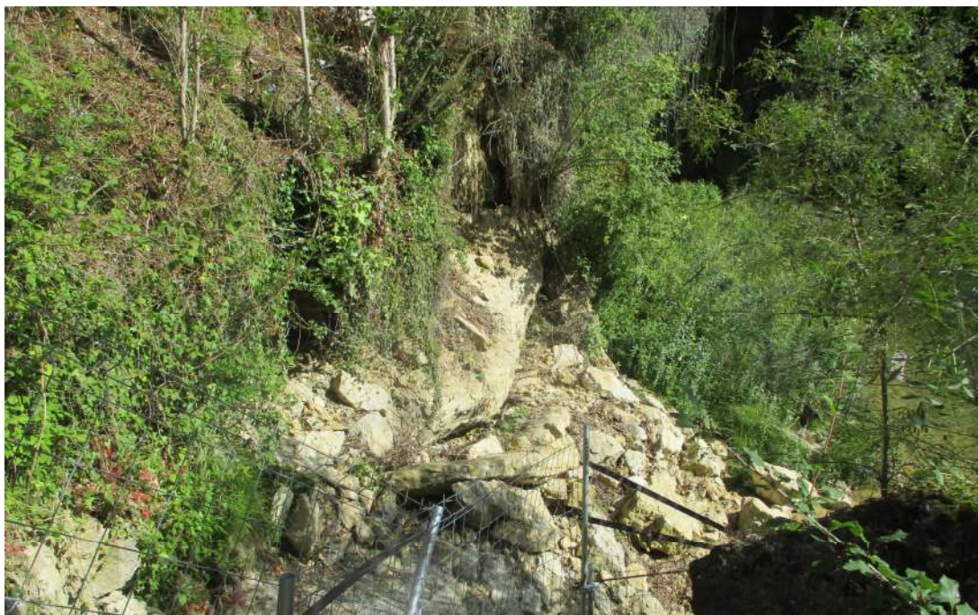
VISTA PARCIAL DE LOS DESPRENDIMIENTOS
