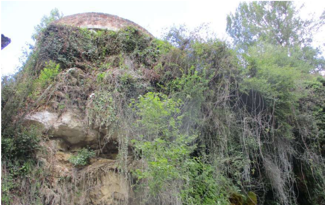
TALUD ROCOSO DONDE APOYA EL MIRADOR. SE PUEDE OBSERVAR LA INESTABILIDAD DE LA ROCA
