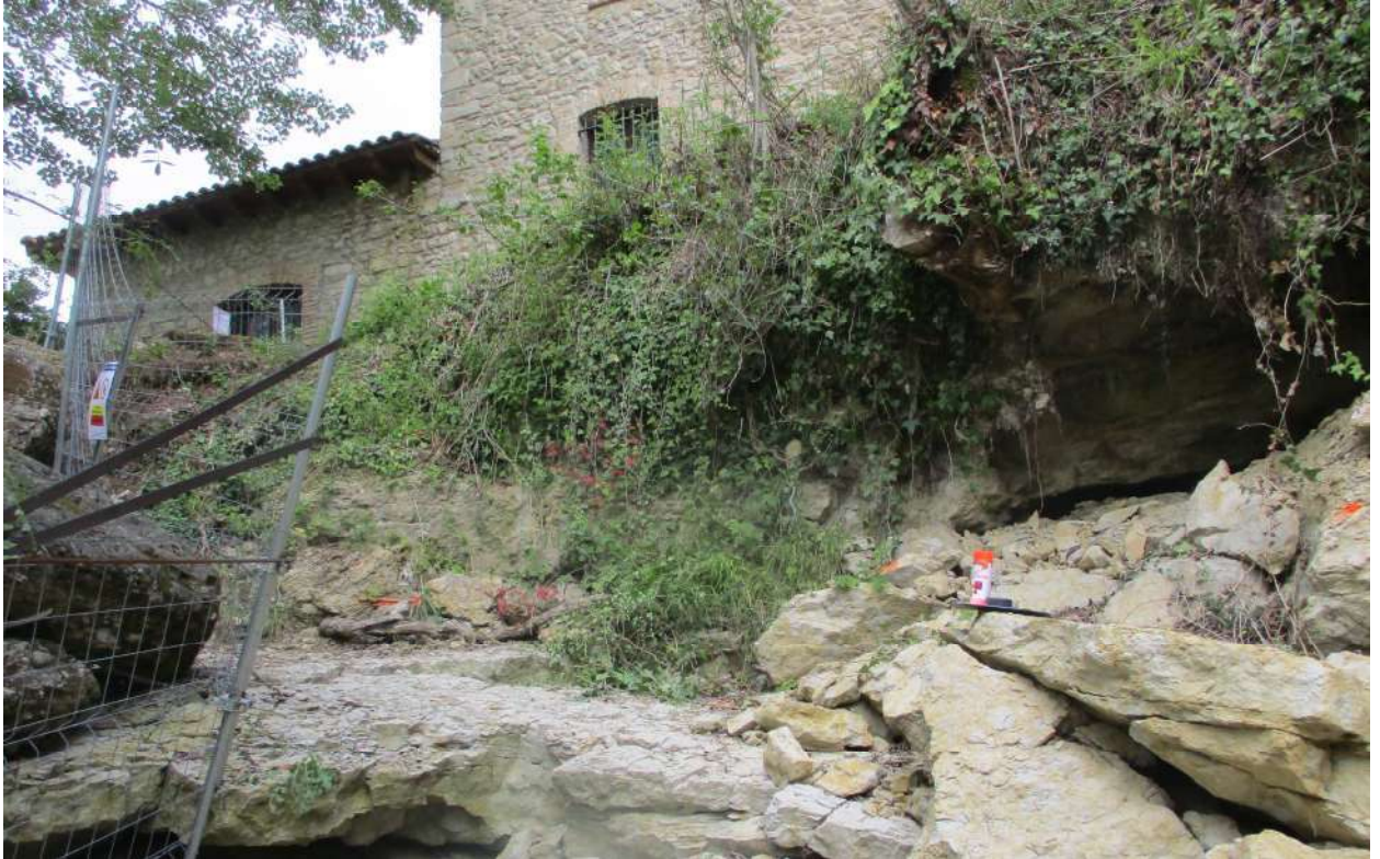
VISTA PARCIAL DE LOS DESPRENDIMIENTOS
