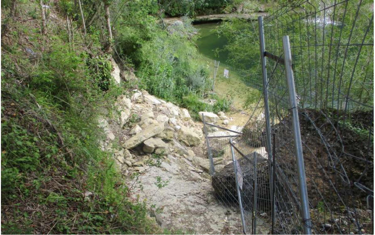
VISTA PARCIAL DE LOS DESPRENDIMIENTOS
