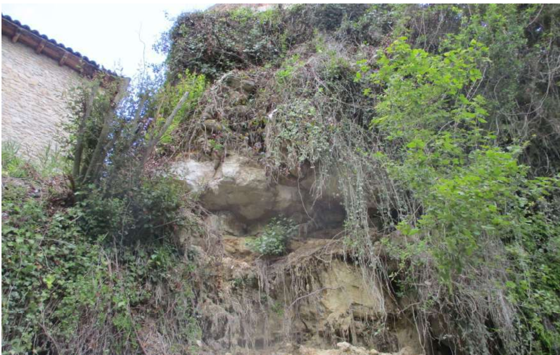
VISTA PARCIAL DEL TALUD DE ROCA (TOTALMENTE DISGREGADA)
