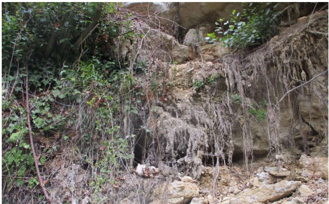
PIE DEL TALUD DE ROCA (MUY EROSIONADO)
