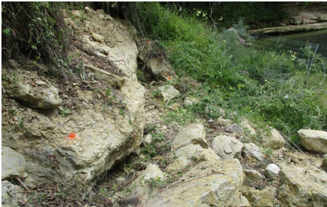
DETALLE ROCAS DESPRENDIDAS
