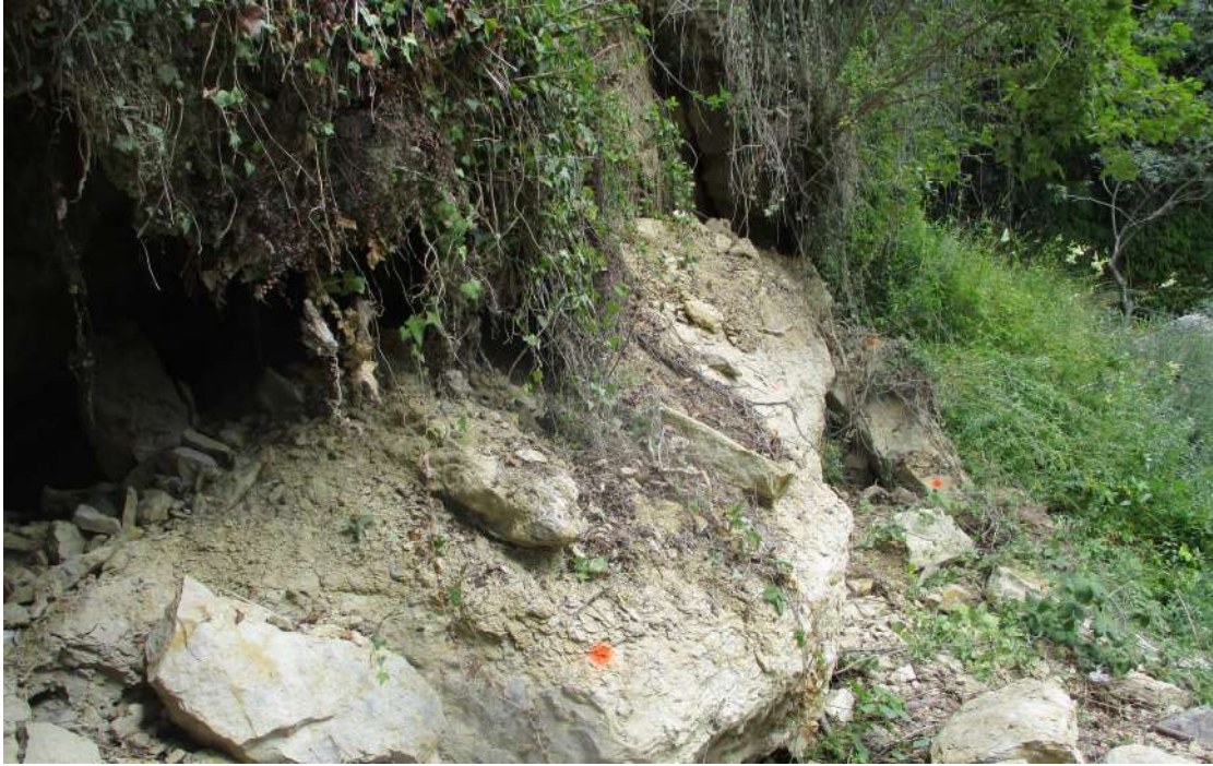
DETALLE ROCA DESPRENDIDA
