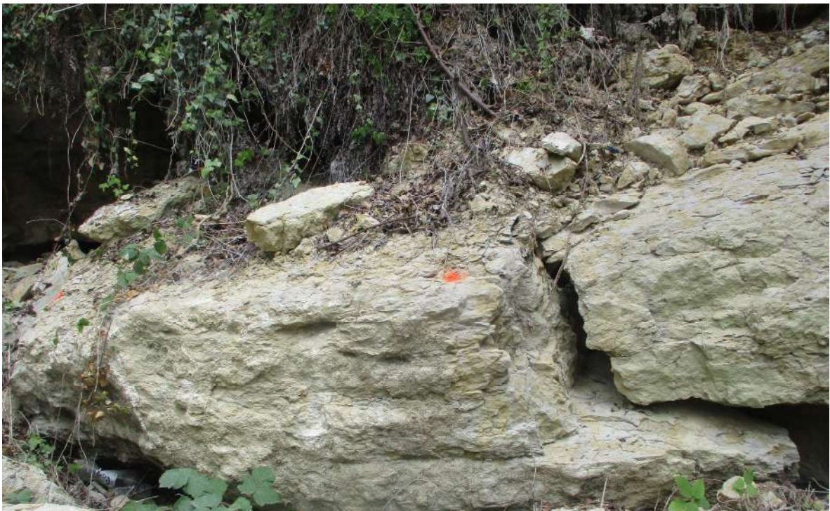
DETALLE ROCAS DESPRENDIDAS
